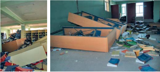
Şekil 2. 2011 Van Depremi ardından Van Yüzüncü Yıl Üniversitesi Ferit Melen Kütüphanesinde oluşan hasarlar 4 .
